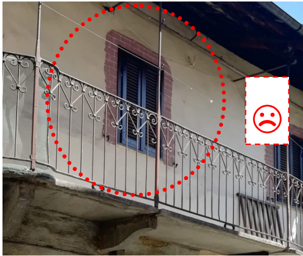
Cornice di finti mattoni, impropria
