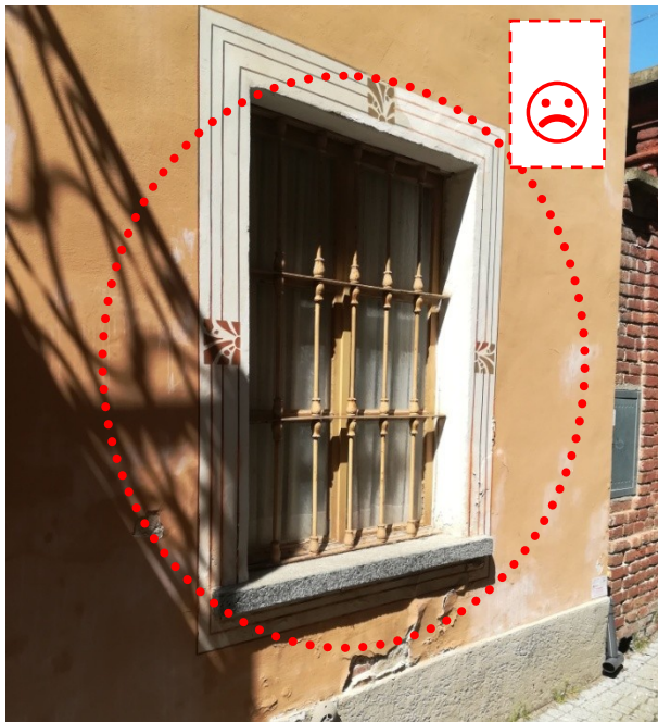
Cornice lineare dipinta, eccessivamente articolata
